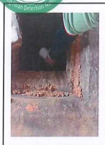
生活污水排放口
