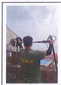
厨房油烟废气处理前
